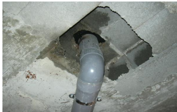
Fig. 2: Humedad debido a la pérdida de una cazoleta
